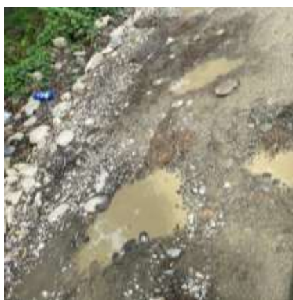
Kondisi akses jalan yang hancur
