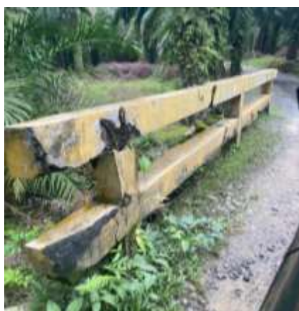
Dinding jembatan yang sudah rusak
