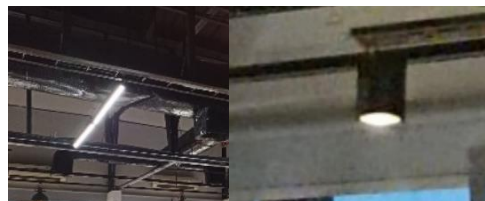
Gambar 12. Lampu plafon balok LED (kiri) dan lampu plafon sorot (kanan)
